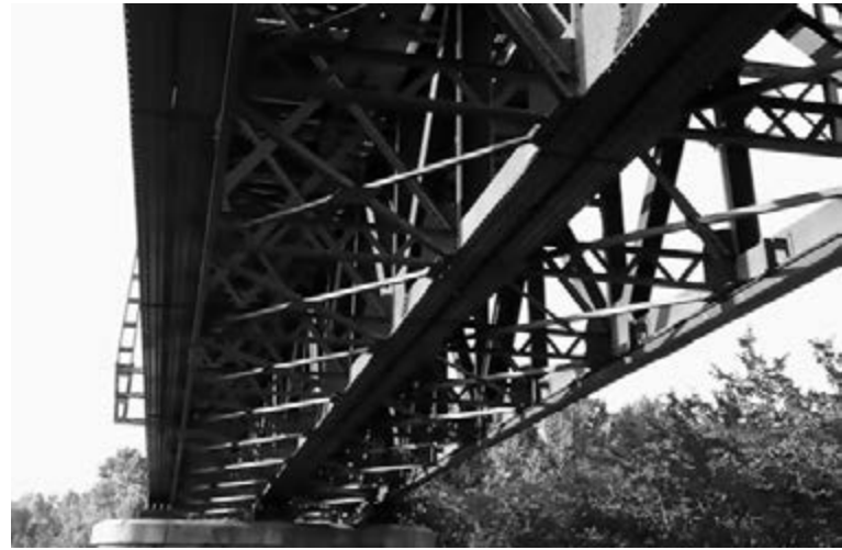
Vista des de baix del Pont Eiffel de Flaçà. Fotografia de Josep Pagès
